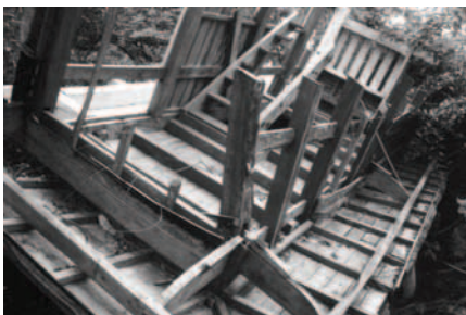
9. 守望樓被鋸斷，屋頂翻落地上
