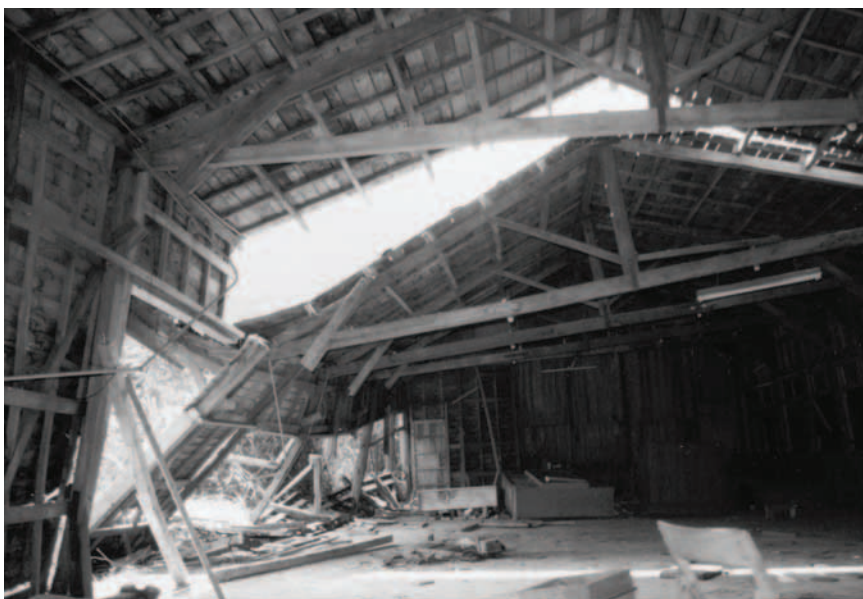
5. 會所屋頂被鋸，裂為兩半
