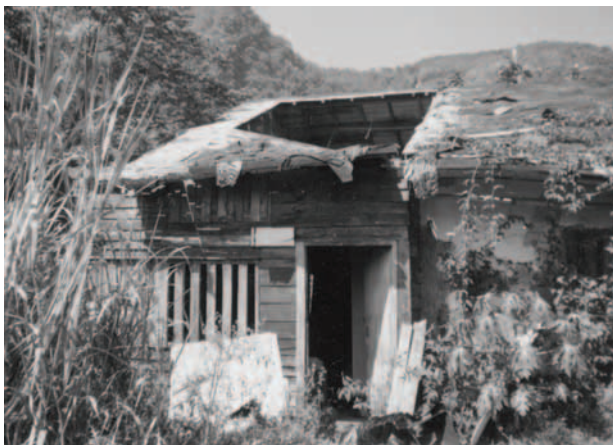
3. 屋頂被鋸開的倉庫
