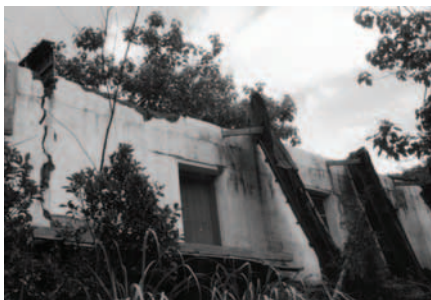
13. 土房子屋頂全被打落
